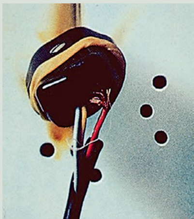
Defekte Kabel und Stecker bergen Brandrisiken
