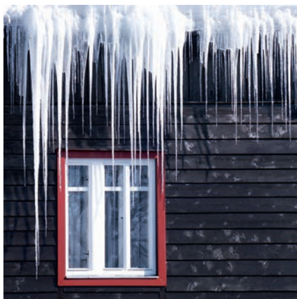
Frost kann enorme Schäden verursachen
