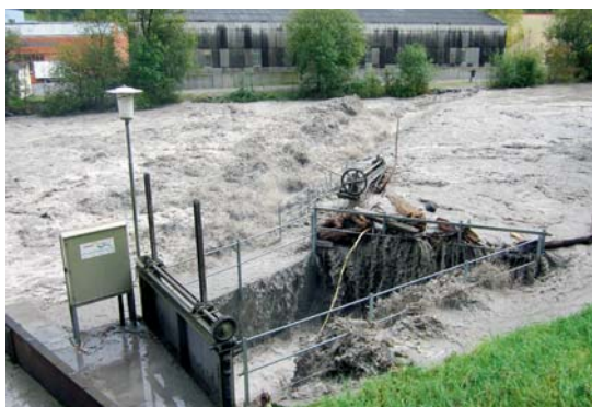
Die Hochwasser führende Linth in Ennenda
